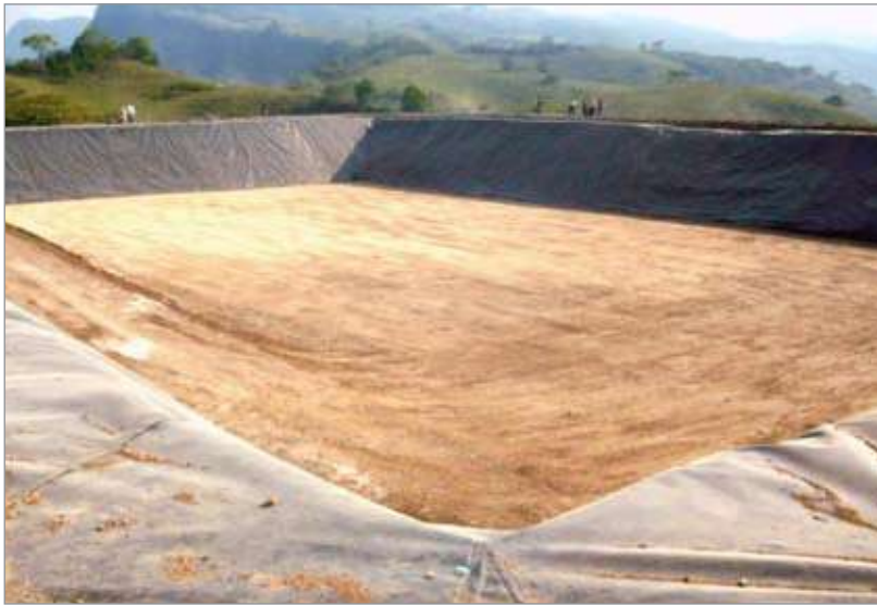
Infraestructura para disposición final de residuos sólidos
