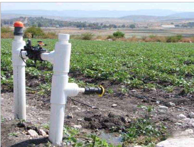
Sistema de riego por goteo
