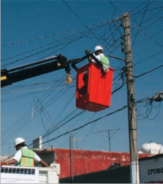
Modernización del alumbrado público. Ciudad de Puebla.
