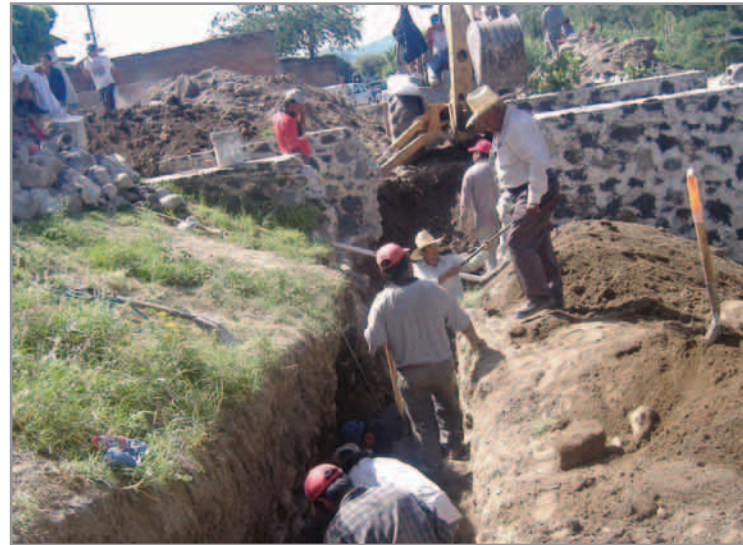
Construcción de colectores marginales de la ciudad de Izúcar de Matamoros, primera etapa.
